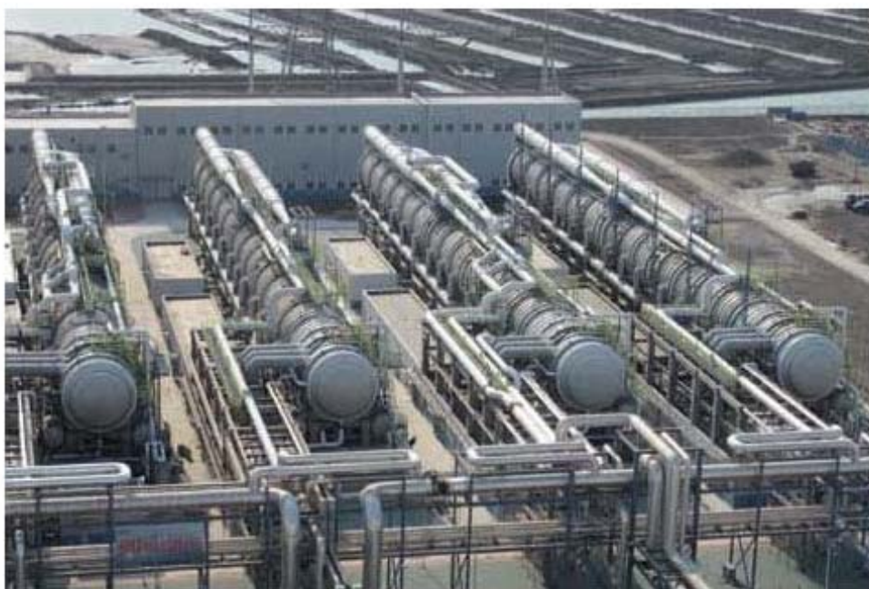
Figure 4. Parallel IDE MED units, 4 x MED 25,000m 3 /day Units, Tianjin, China.
